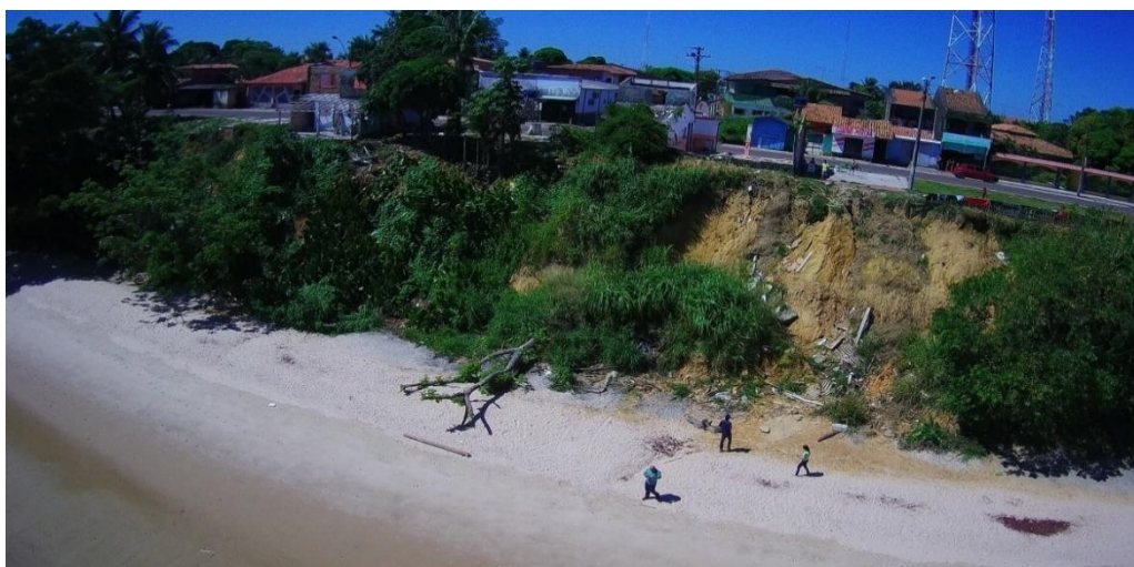
Figura 2. Suscetibilidade de deslizamentos de massa envolvendo residências
